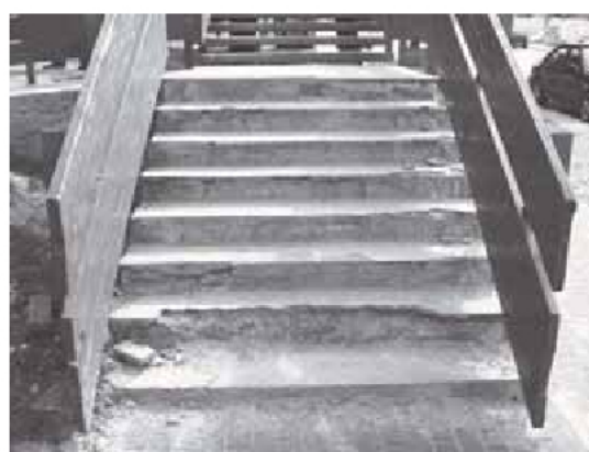
B. Schody z licznymi ubytkami korozyjnymi.
