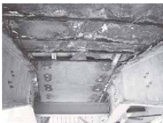
C. Skorodowane, z licznymi ubytkami trepy schodów.
