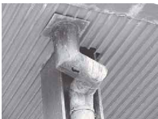
A. Silnie uszkodzone przez korozję rury spustowe.
