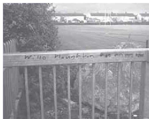
D. Barieroporecze z licznymi napisami i nielicznymi śladami korozji.
